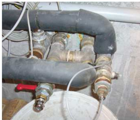
Abb. 19 Sole - Sondenkopf mit Glasfasermesskabel
