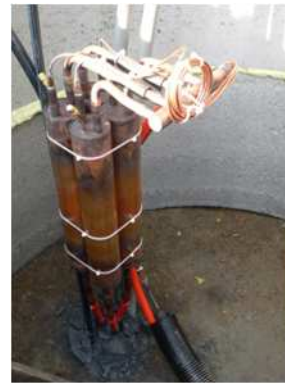
Abb. 8 Sondenkopf mit Kälteleitungen Neumarkt
